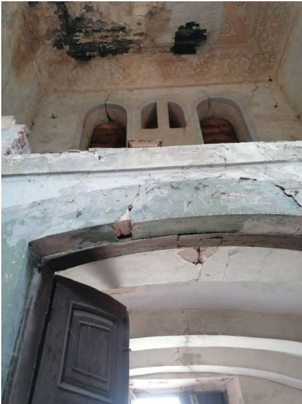
Zdj.5 Rysa nad drzwiami wejściowymi (u dołu) w schemacie „a”; wypadanie cegły z łuku (pośrodku); rysy nad oknami (nad chórem) w schemacie „a”
