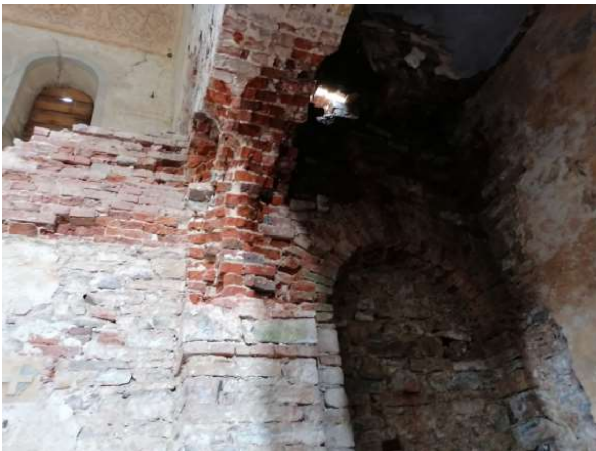
Zdj.8 Ubytek sklepienia nawy północnej. Widoczny otwór w dachu przez który latami wpływała woda.
