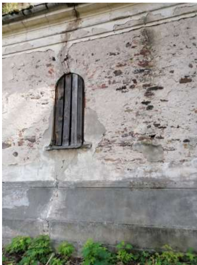
Zdj.2 Zarysowanie od fundamentów po gzyms na ścianie południowej
