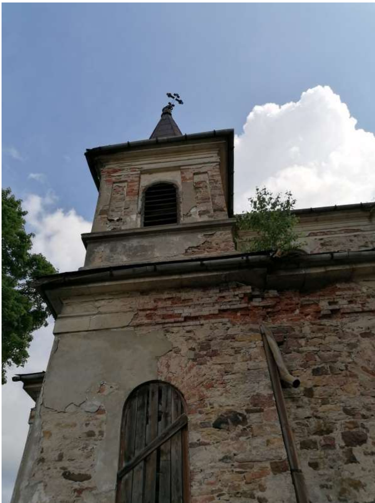
Zdj.4 wyrwa w murze po stronie południowej, odspojony tynk pokazuje konstrukcje gzymsu.
