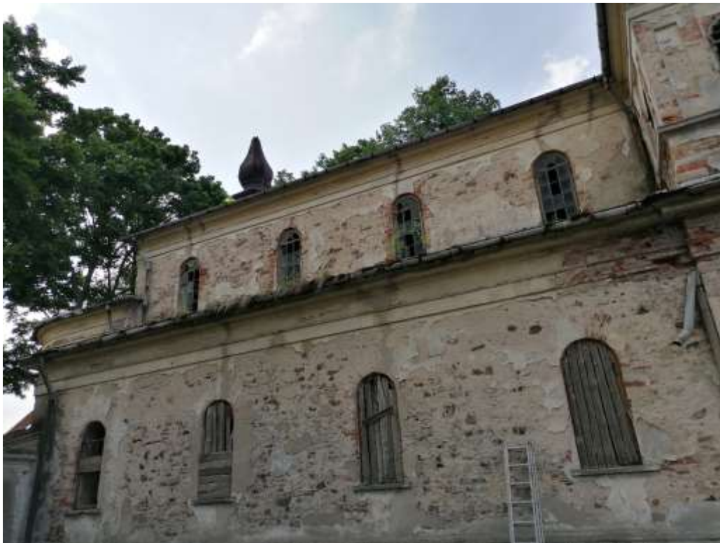
Zdj.7 Zarysowane sklepienia okien
