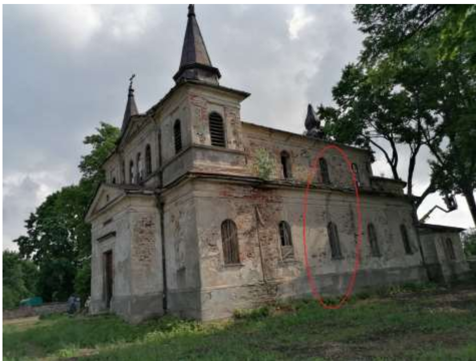
Zdj.1 Widok strony południowej z zaznaczoną rysą pionową.
