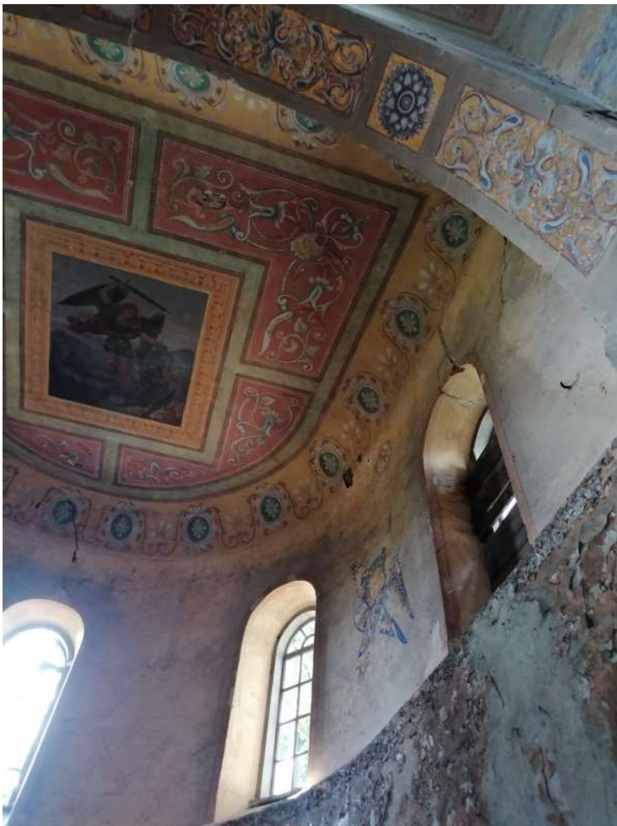
Zdj.10 Sufit prezbiterium z obrazem do zabezpieczenia
