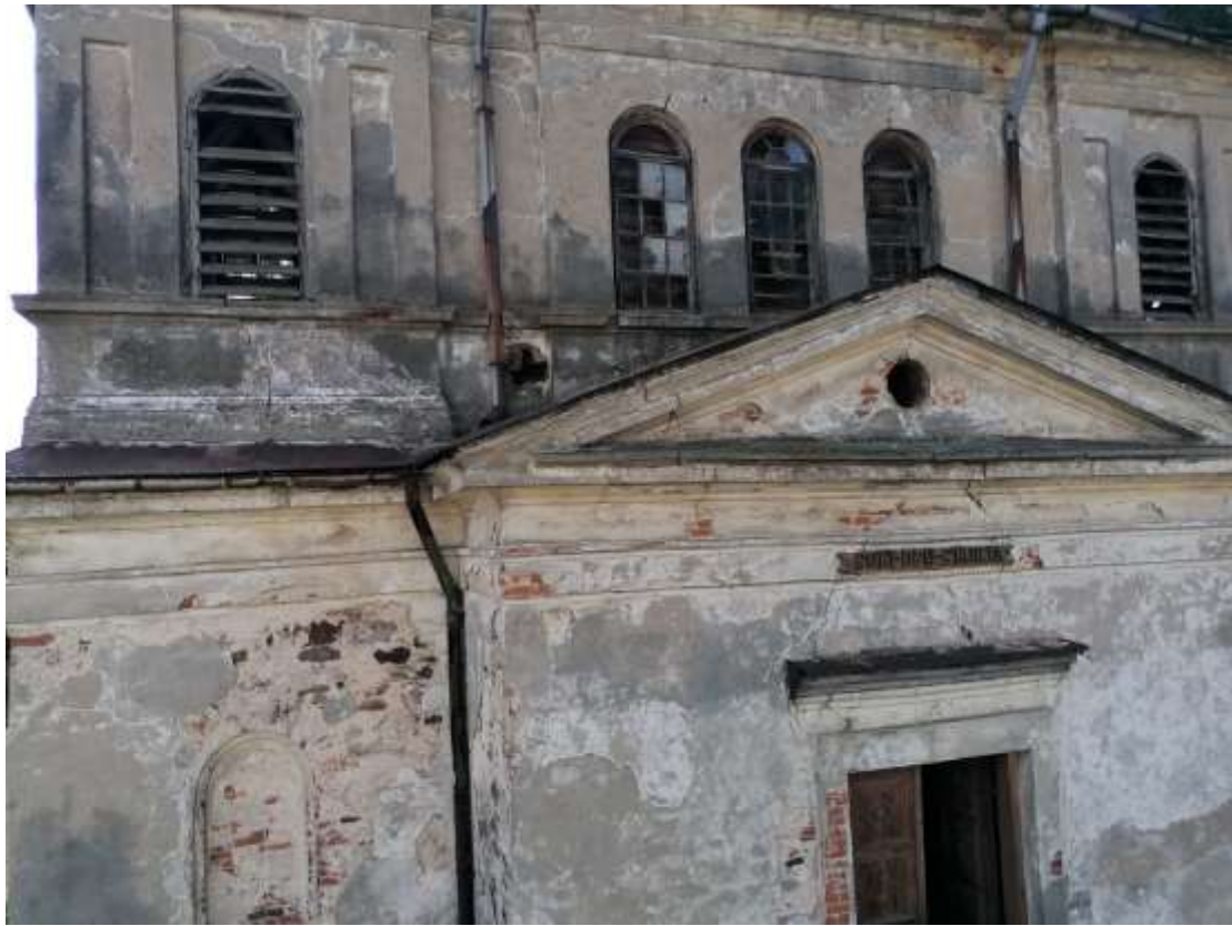
Zdj.3 Zarysowania ściany frontowej: pod oknem dzwonnicy (lewe górne), skośne rysy nad drzwiami w obu kierunkach aż do gzymsu
